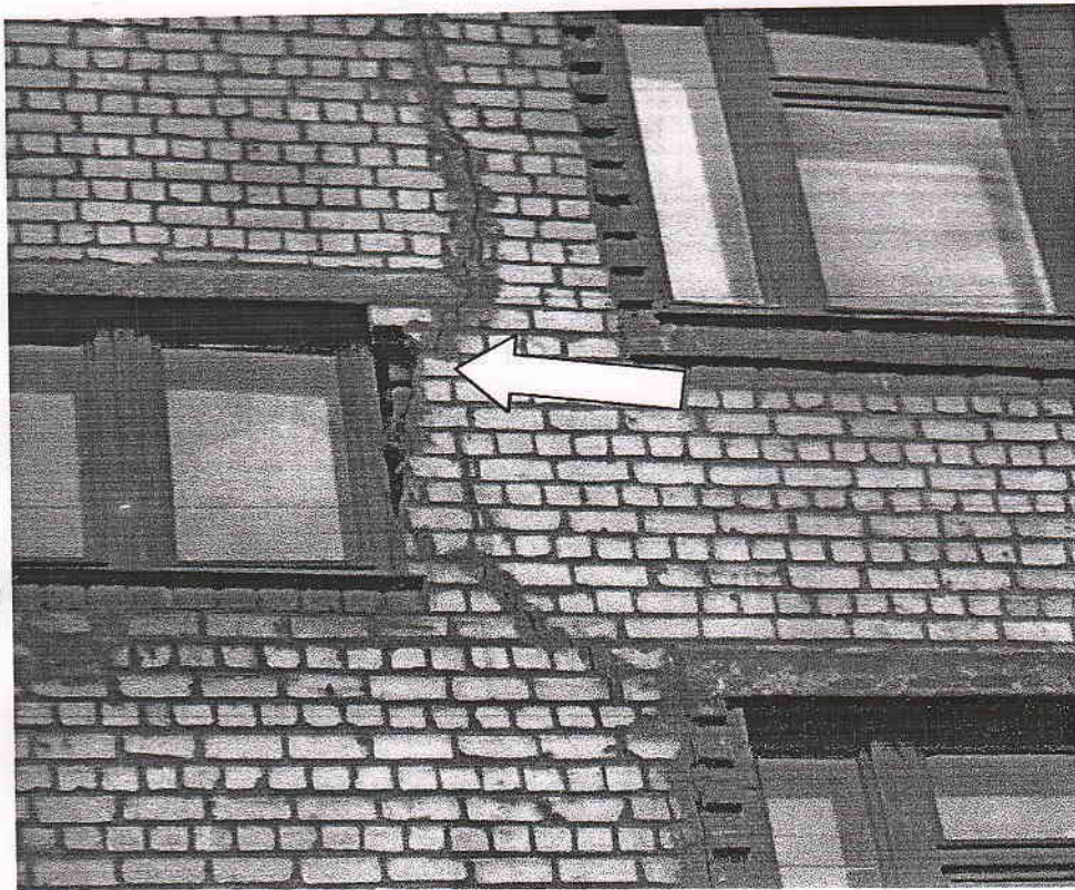
Д2 Срезающие трещины в опорной части стен под оконными и дверными проемами;
