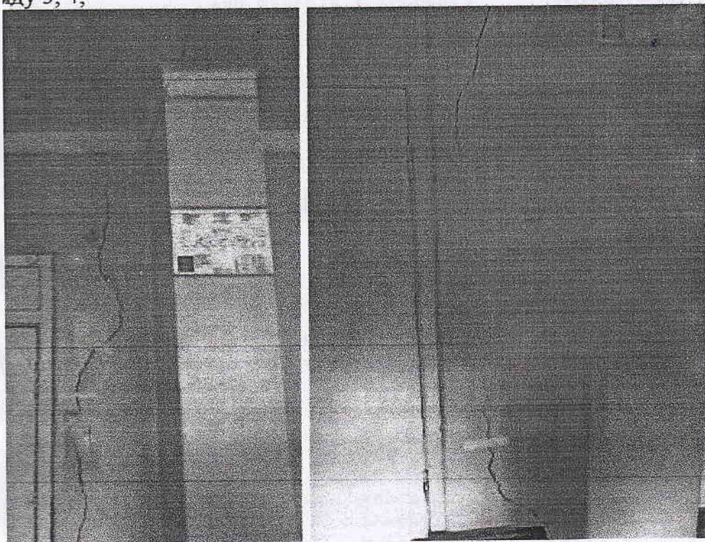
Д1 Вертикальные трещины в наружных и внутренних кирпичных стенах, на всю высоту здания, шириной раскрытия от 5 до 50 мм. В осях Н – Ц, по ряду 1, 3, 4, и в осях по ряду 3, 4;
