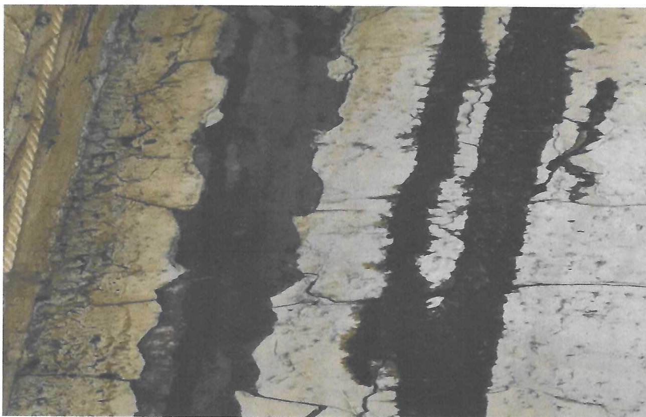
Рис.3.5. Руйнування, тріщини стіни квартири 98 після вибуху та пожежі
