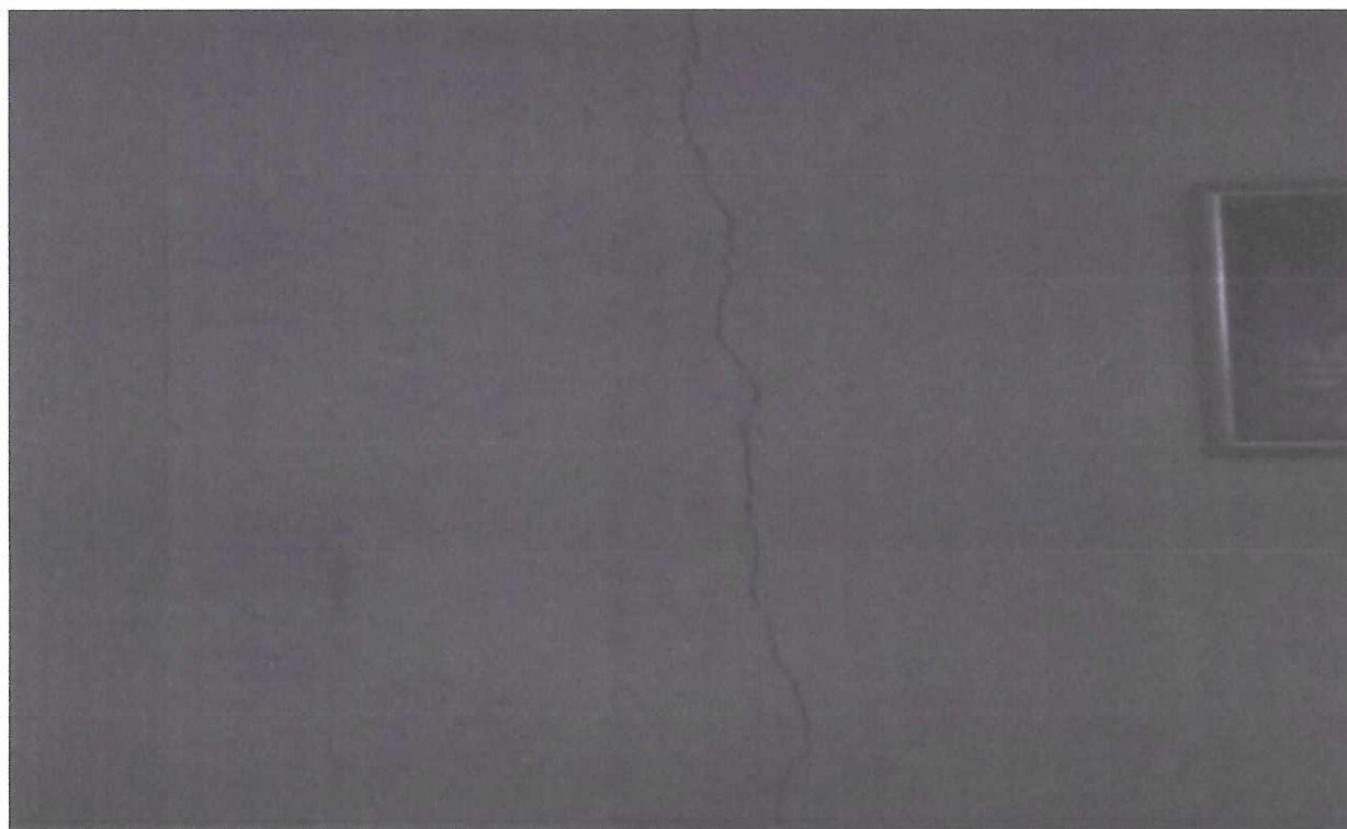
Рис. 3.3. Вертикальні тріщини в зовнішній стіні, втрата «геометрії» перев'язки кладки стін, повне знищення внутрішнього опорядження стін
