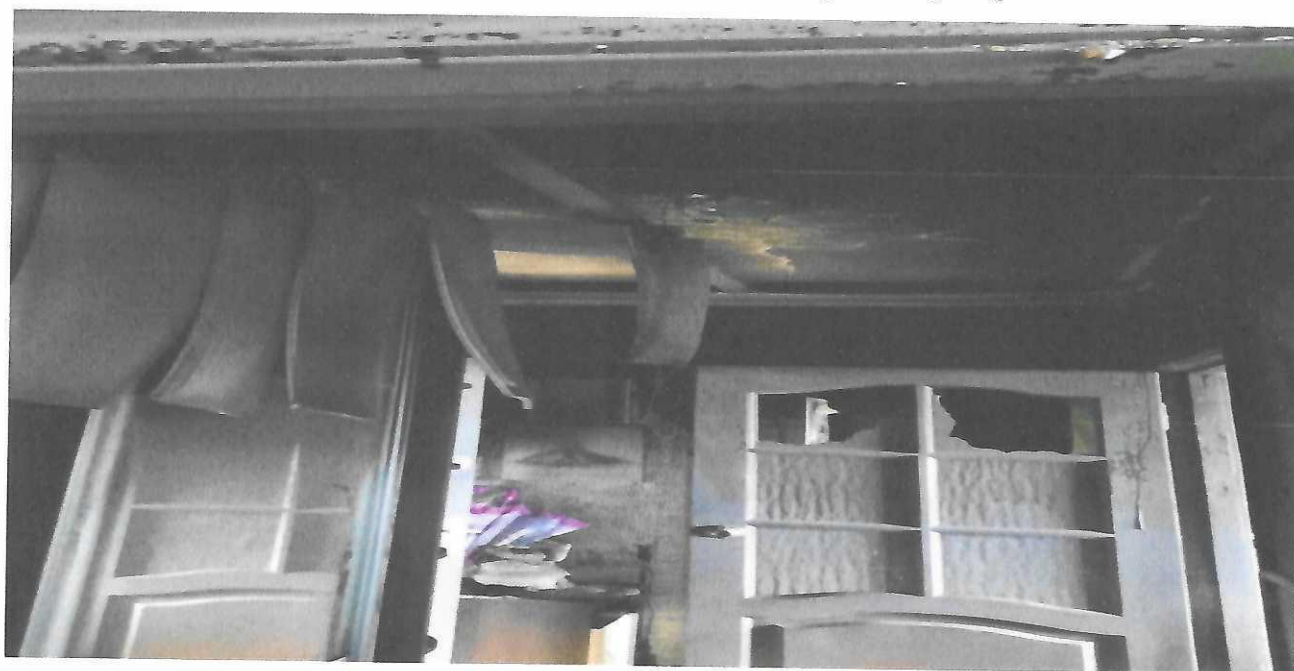
Рис.3.9 Руйнування дерев'яні двері у квартири 97
