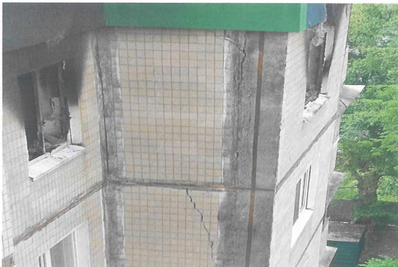
Рис.3.7 Тріщини зовнішніх стін 6-го та 7- го поверху будинку 61
