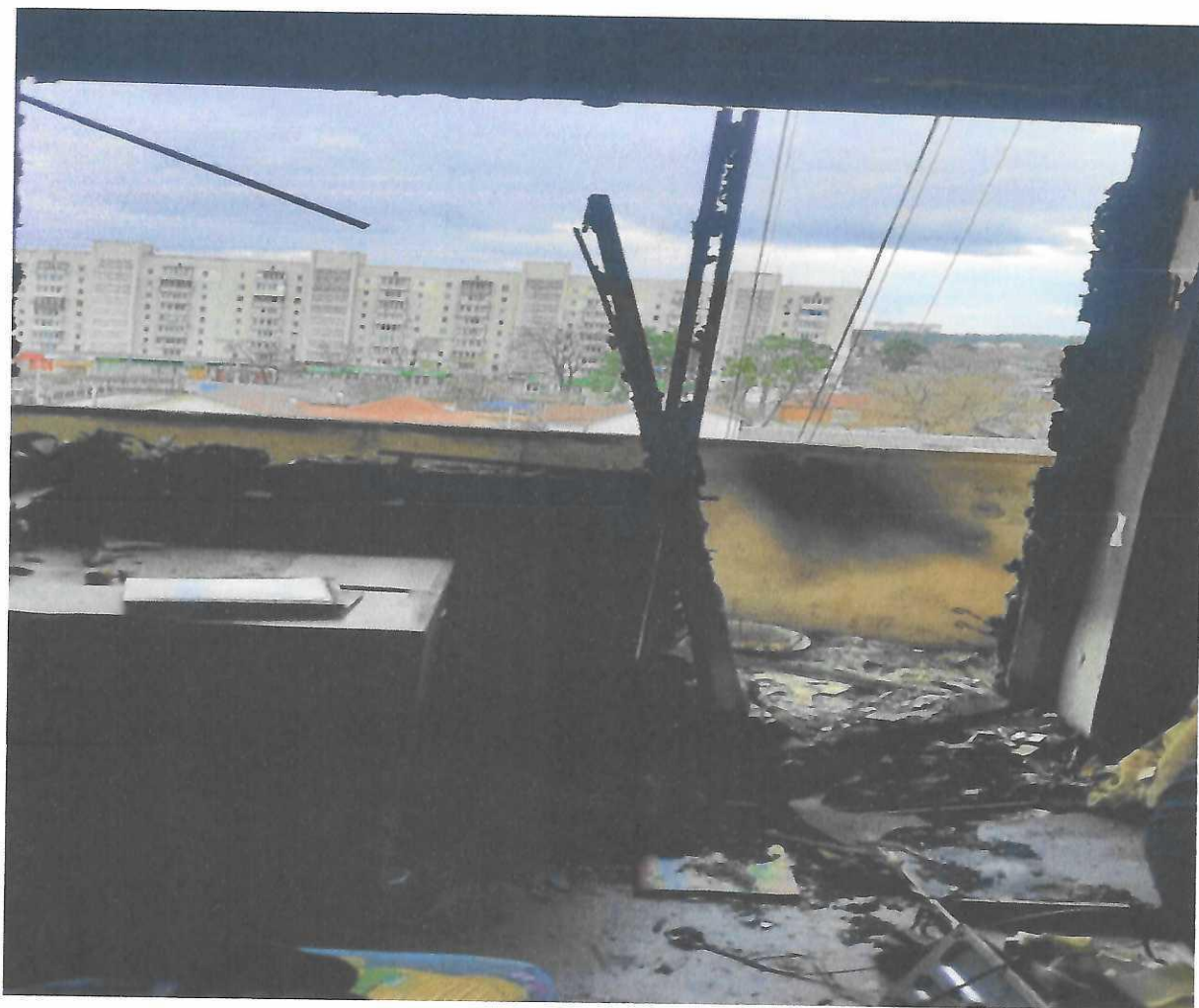
Рис.3.8 Пошкодження вікон та двері квартири 97
