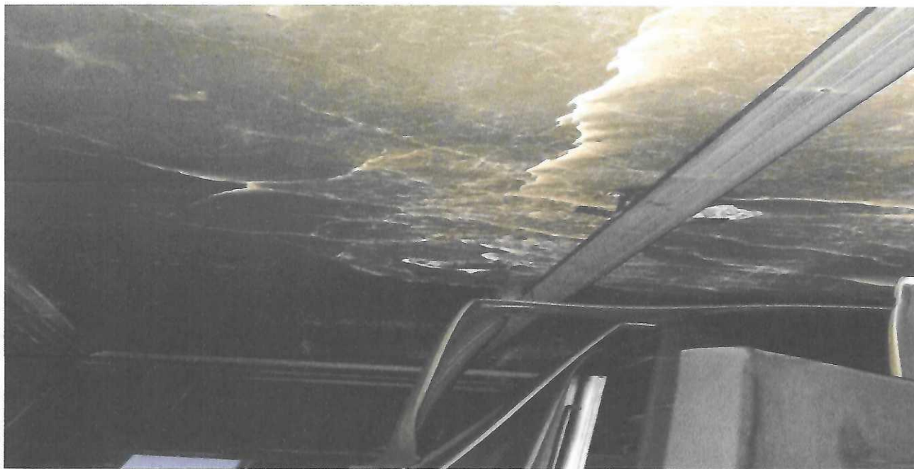
Рис.3.6 Пошкодження та тріщини стіни у квартири 98
